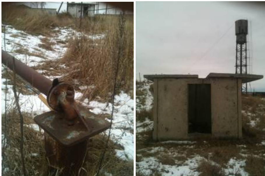
Рисунок 12 - Действующие водозаборные скважины на площадке водопроводных сооружений д. Чаргары
