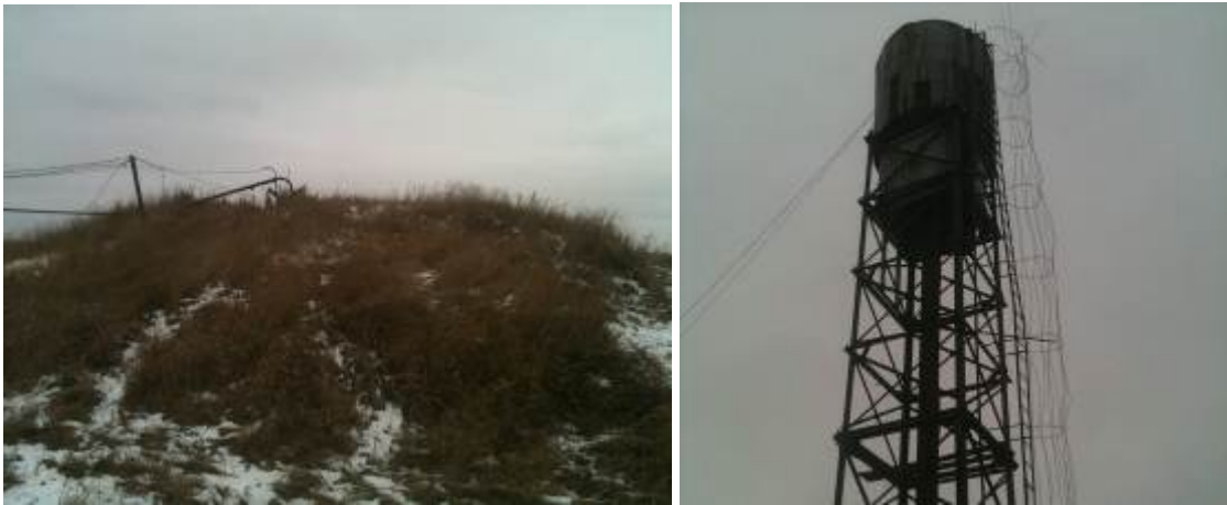
Рисунок 13 – Регулирующие водопроводные сооружения на территории д. Чаргары слева: действующий резервуар чистой воды; справа: недействующая водонапорная башня
